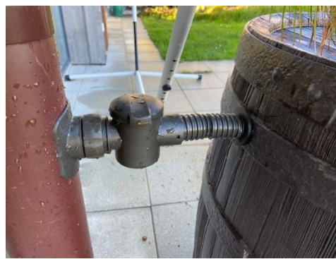
Photo 2 : Exemple de raccordement à la gouttière
